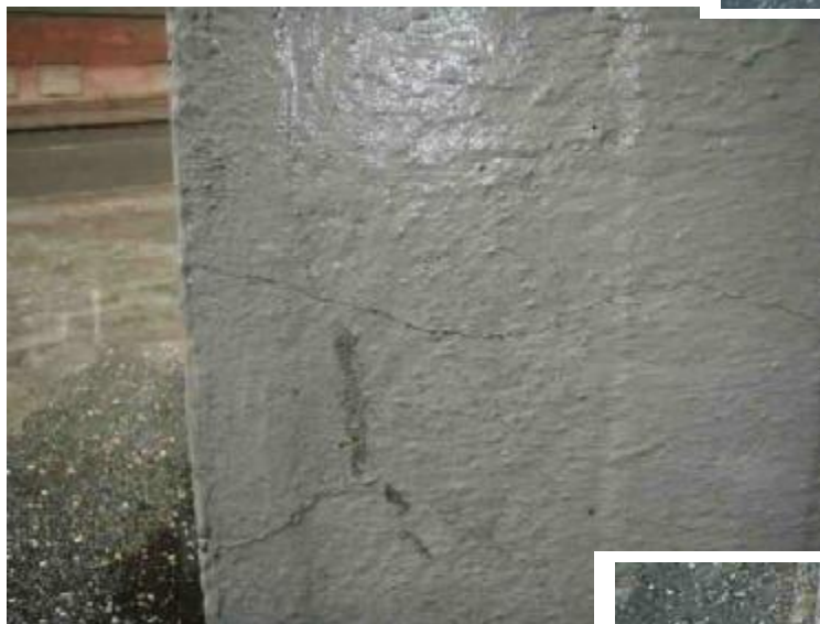
Mikrotrhliny v celém obvodu podstavce.
