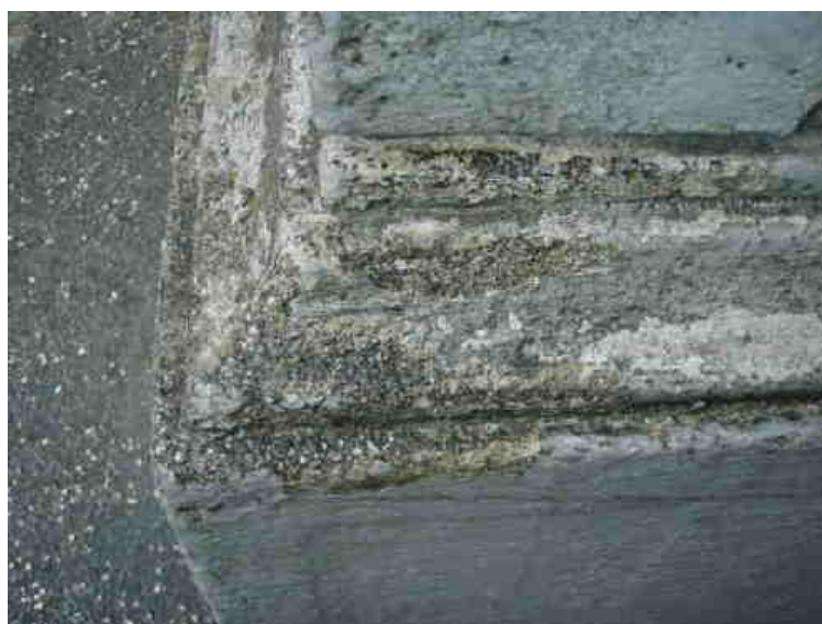
Destrukce teracové vrstvy v parapetní poloze. Situace shodná se stranou C.
