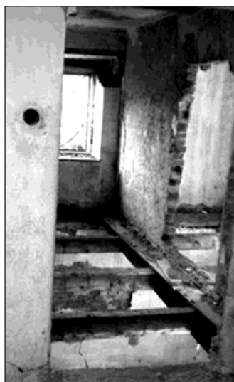
Vnitřní prostory starého mlýna jsou v dezolátním stavu.
